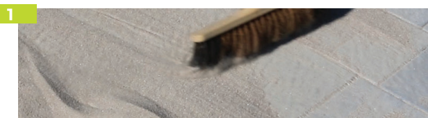
1 Employer un sable fin qui sera soigneusement balayé dans les interstices entre les pavés.
