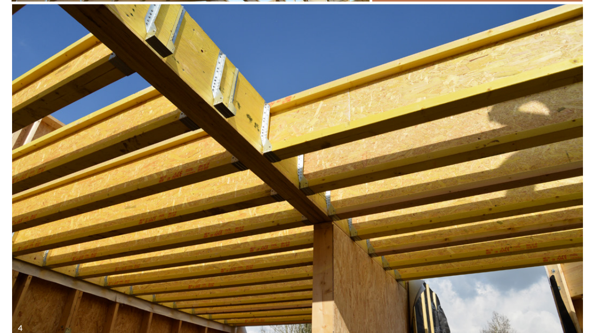
1. Chevrons porteurs "L'invitation au voyage (Honfleur) / 2 et 3. Montants d'ossature / 4. Solives de plancher d'étage
