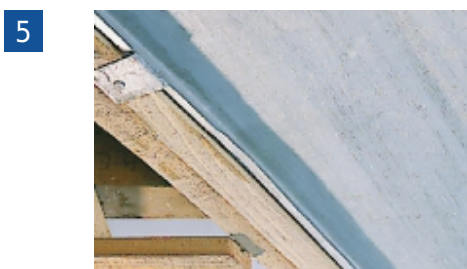
5 Mise en place de la noue métal façonnée à relevés, contre liteau filant et patte de fixation.
