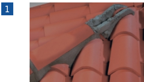
1 Après coupe des tuiles d'approche, mise en oeuvre des tuiles Canal 230-50, utilisation de mortier (D.T.U. 40.22 art. 2.4).
